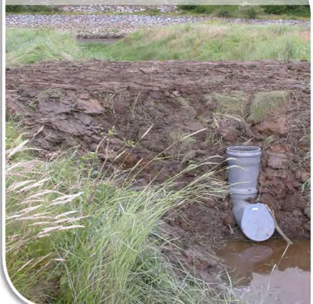
Mise en place d'un système de trop-plein et de clapets pour gérer le niveau d'eau d'un marais.
